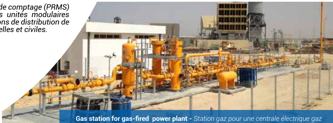
Indirect water bath heater - Réchauffeur à bain d'eau indirect
